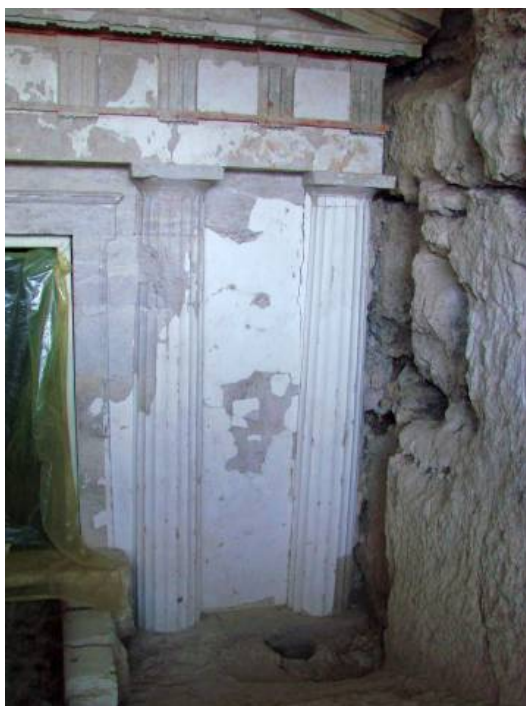
Εικ. 25. Απολέπιση, αποσάθρωση και εκτεταμένες μικρο ρωγμές επιχρισμάτων και επιφανειακών στρωμάτων πέτρας.
