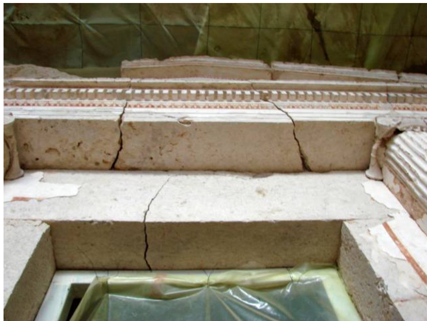
Εικ. 28. Τάφος Γ'. Ρωγμές, λόγω κάμψης, πάχους 1½ μέχρι 2 εκ. στην επιστήλιο του προθάλαμου.
