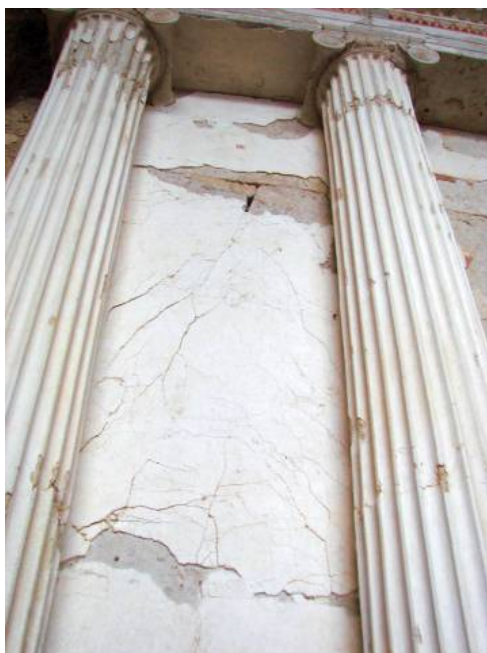
Εικ. 29. Διαγώνιες ρωγμές στην κυρία πρόσοψη του τάφου Γ.
